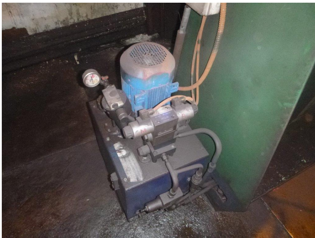
Рис. 4.11. Гідростанція електрогідропривода укладальника
