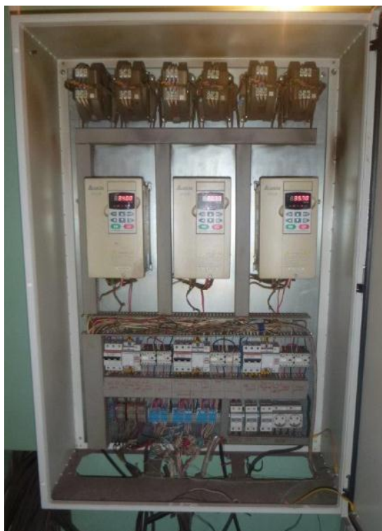
Рис. 4.10. Шафа перетворювачів частоти електрогідроприводів укладальників
