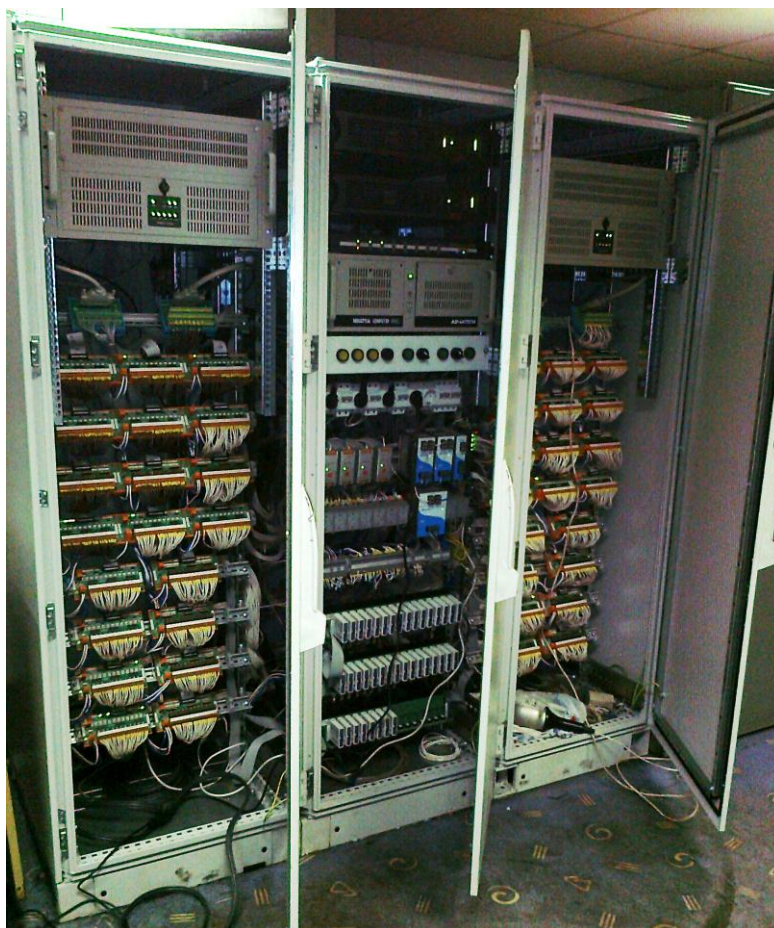
Рис. 4.6. Шафи керування ділянкою моталок (основна—зліва, резервна—справа) і шафа серверного и комунікаційного обладнання (в центрі)
